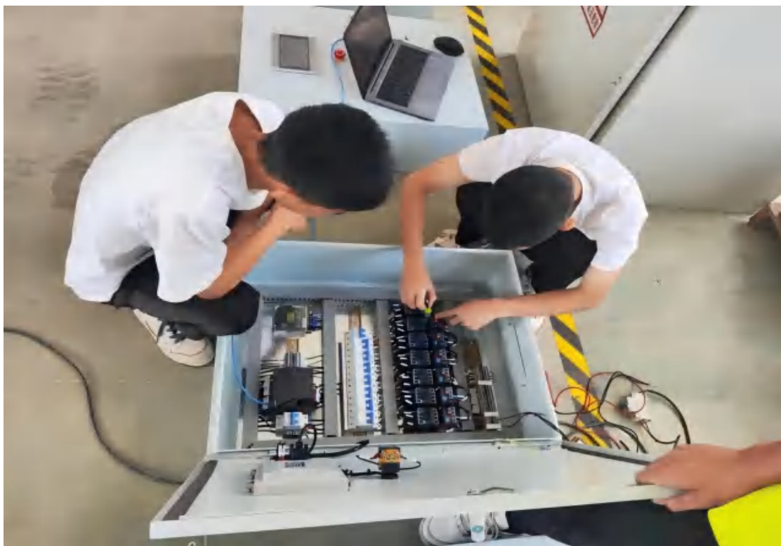
图 2-2 零陵机场油榨头村污水处理控制柜
